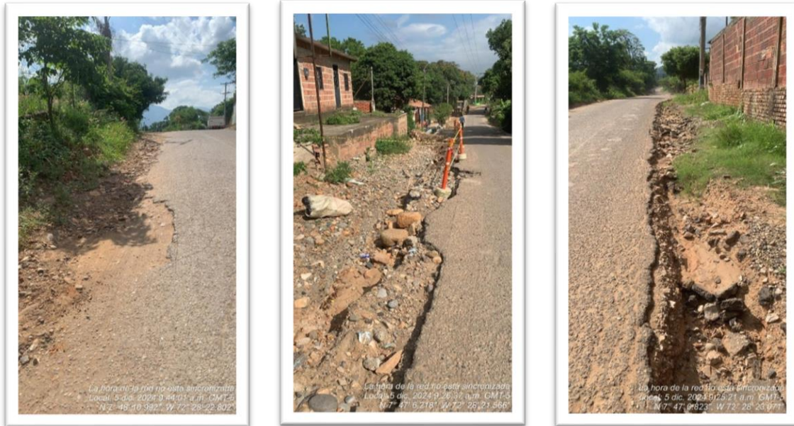
Fotografía No. 10,11 y 12 . Tramos sin recuperar pavimento
