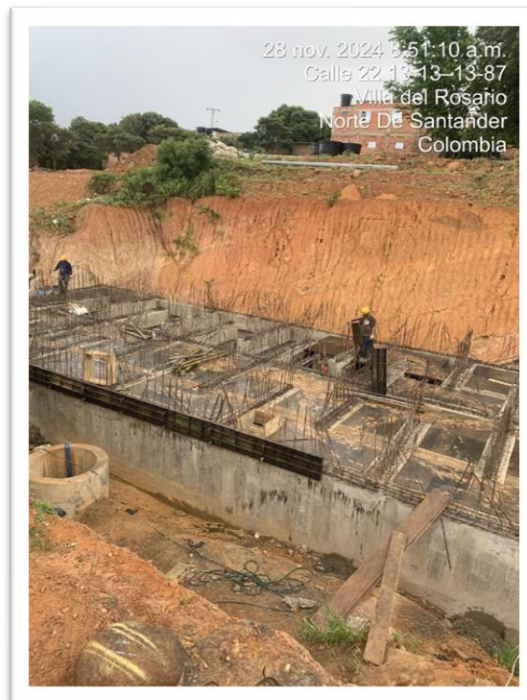
Fotografía No.8 construcción tapa de la cámara de contacto de cloro. Fotografías tomadas el 28 de noviembre
