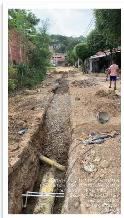
Fotografía No. 5,6 y 7. Excavación a máquina, instalación de tubería PVC y relleno tramo alcantarillado sanitario barrio 20 de Julio.
