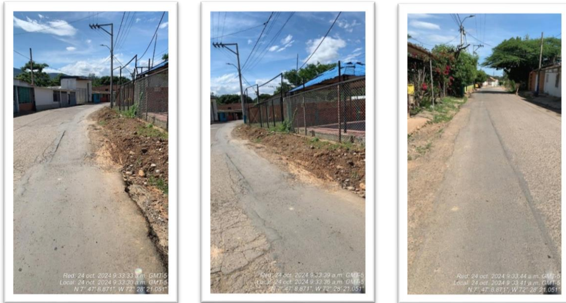
Fotografía No. 23,24 Y 25. Tramos donde hay que recuperar nuevamente el pavimento Fotografías tomadas el miércoles 20 de noviembre
