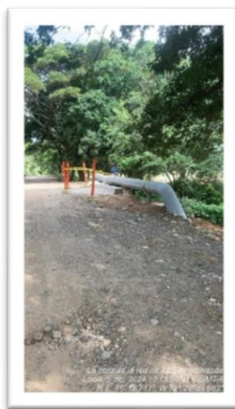
Fotografía No. 1. Estado actual paso especial No. 1.
