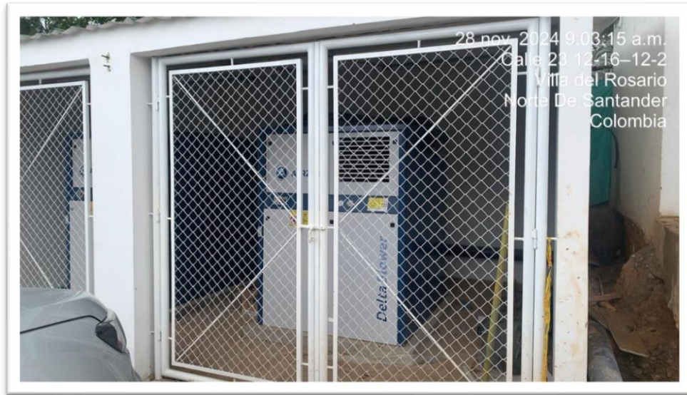
Fotografía No.14,15 y16 filtros nuevos, caseta y sopladores instalados. Fotografías tomadas el 28 de Noviembre
