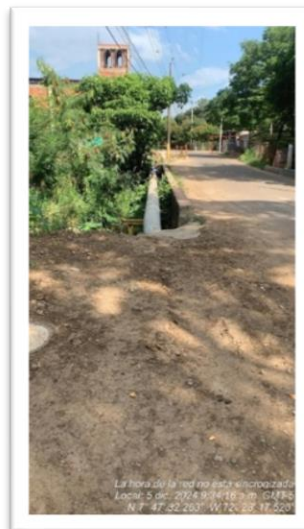
Fotografía No. 3. Estado actual del paso especial No. 3 Fotografías tomadas el 5 de diciembre 2024
