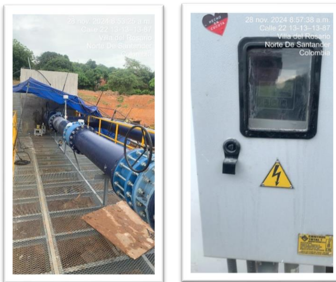
Fotografía No.4 y 5. Macromedidor instalado, Fotografías tomadas el 28 de noviembre
