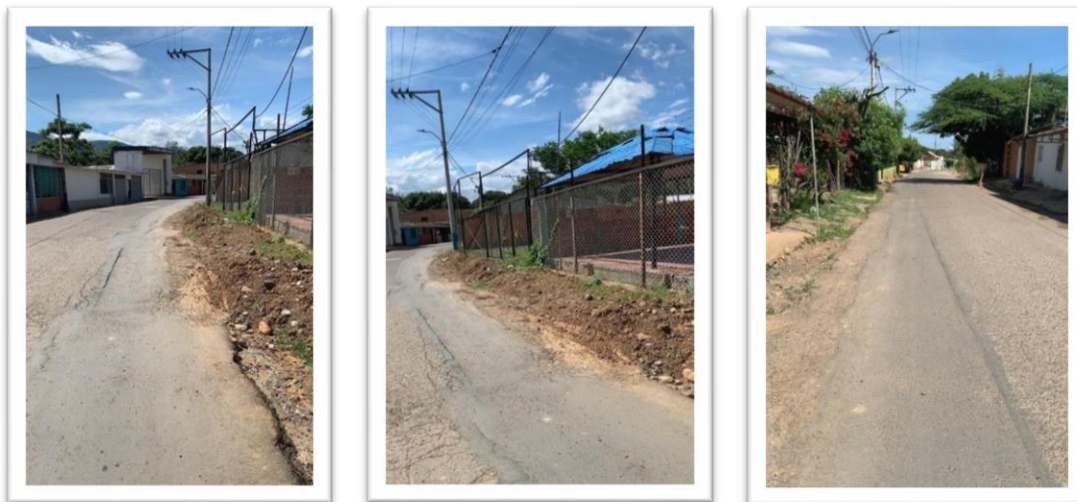
Fotografía No. 13,14 y . Tramos de pavimento instalado hundido y fallado
