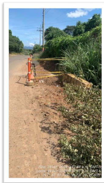
Fotografía No.13. Estado actual paso especial No. 7
