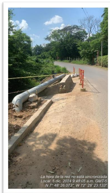
Fotografía No. 9. Estado actual paso especial No. 9
