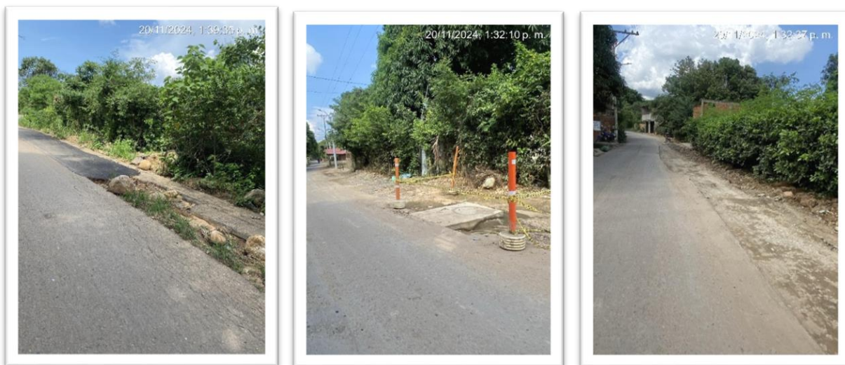
Fotografía No. 20,21 y 22. Tramos sin recuperar pavimento Fotografías tomadas el miércoles 20 de noviembre
