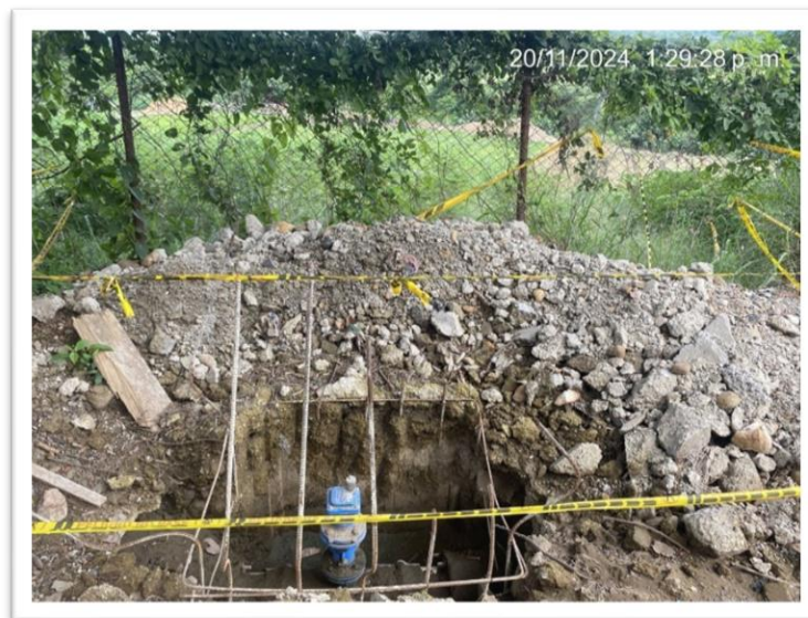
Fotografía No. 26. Caja sin terminar Fotografías tomadas el miércoles 20 de noviembre
