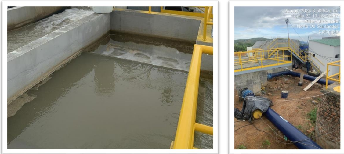
Fotografía No. 8 y 9 Cámara de distribución de caudales, y empalmes a los trenes de tratamiento
