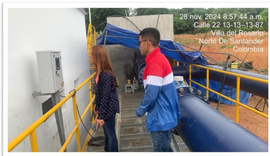
Fotografía No.3. Macromedidor instalado, Fotografías tomadas el 28 de noviembre
